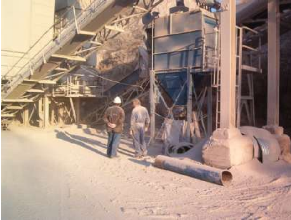
Figura 9 Unidad de filtrado conectada a la campana
