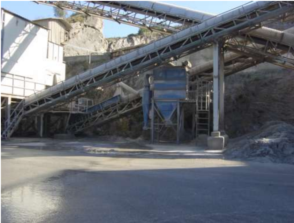
Figura 15 Ambiental zona tras las instalación del sistema
