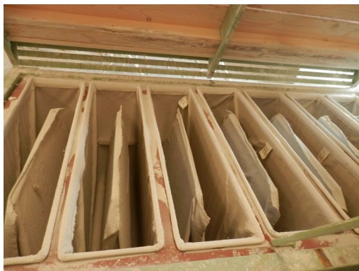
Fig. Filtros saturados debido a un mal mantenimiento, que pueden llegar a inutilizar el sistema o eliminar su eficacia. Esto, tanto en el caso de filtros para decantar polvo cuando se extrae aire mediante captaciones, como filtración de aire que se introduce en la nave. En todos los casos es fundamental contar con un plan de mantenimiento específico rigurosamente implantado.
